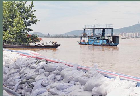
7月5日,长沙城区湘江沿岸危险堤段已经全部用沙袋加固加高,确保安全度汛
