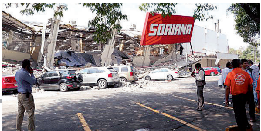
9月19日,在墨西哥首都墨西哥城拍摄的一处在地震中倒塌的大型超市。
