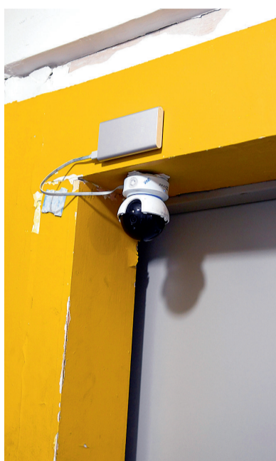
电梯口设置监控观察烟气蔓延情况
