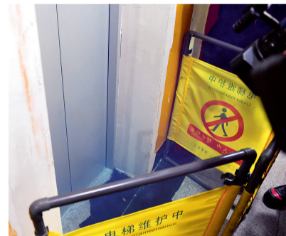
烟气通过电梯门的缝隙蔓延至其它楼层
