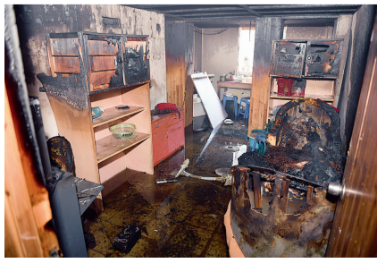
现场被烧成废墟
