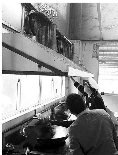
检查存在隐患的油烟管道
